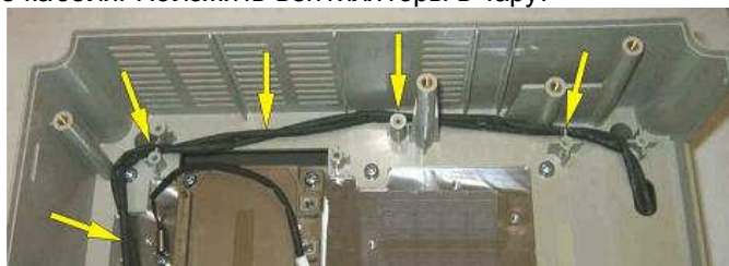
Рис.6.21 Стрелками показаны кабели вентиляторов
